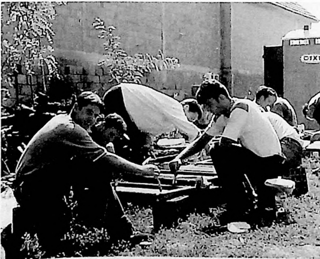
Kozijnen schilderen. Herstel van de school van Randubrava; de lokale bevolking helpt actief mee
